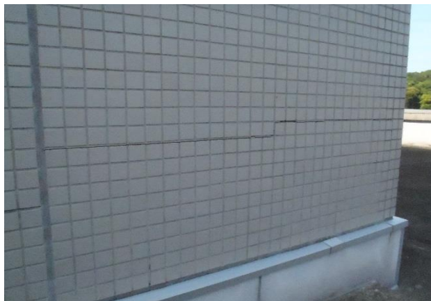
【図表－8】 外壁タイルの劣化状態
